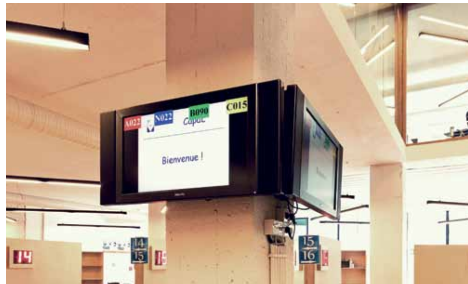
↳ Moniteurs pratiques pour des communications à Bruxelles
